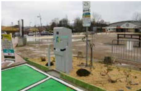
• Borne de recharge électrique
