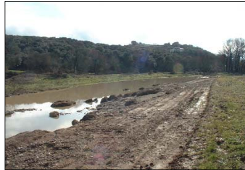
Creusement d'un lit de crue parallèle au cours de l'Avène, dont on aperçoit la ripisylve à l'arrière plan
