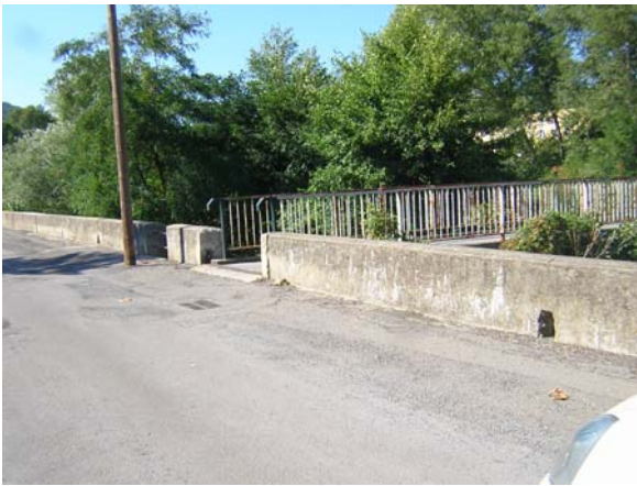
Vue du mur de quai en bordure du Gardon d'Alès sur la commune des Salles du Gardon : Ouvrage présentant des ouvertures dans sa structure (fente de dilatation, ouvrage discontinu, trou d'évacuation ...) au-delà des risques de brèche comme ce fut observé sur la traversée d'Alès (débordement du Grabieux avec retour en lit du Gardon ayant entraîné une brèche dans le mur de quai lors de la crue de septembre 2002
