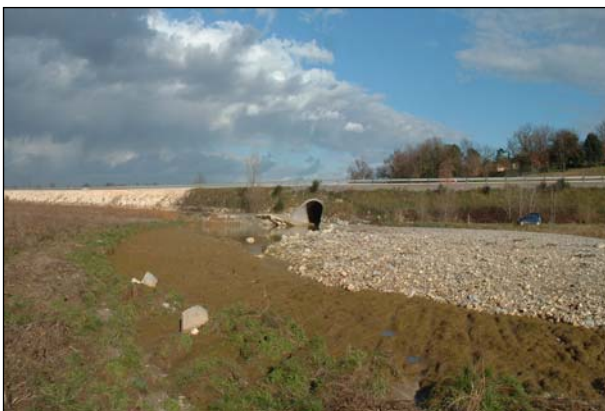
Remblai de la RN 106 au droit du Cheval Vert. Partie érodée et enrochée à gauche, surcreusement et dépôts grossiers à l'aval de la traversée
