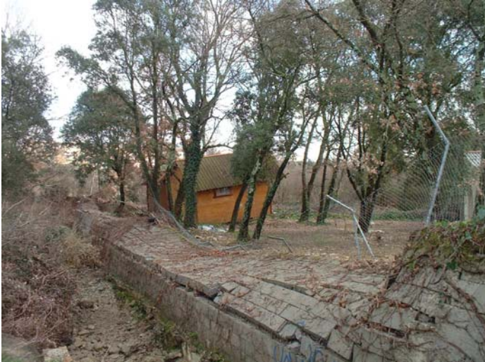
Vue du mur de clôture du camping de Rousson en bordure de l'Avène et d'un petit affluent suite à la crue de septembre 2002
