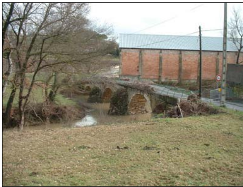
Le vieux pont de la Jasse-de-Bernard, submergé par la crue. Le lit mineur ne représente qu'un tiers de la capacité des arches
